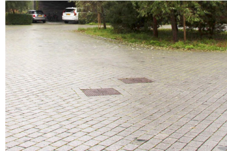
Het hemelwater wordt afgevoerd in een (gescheiden) rioolstelsel
