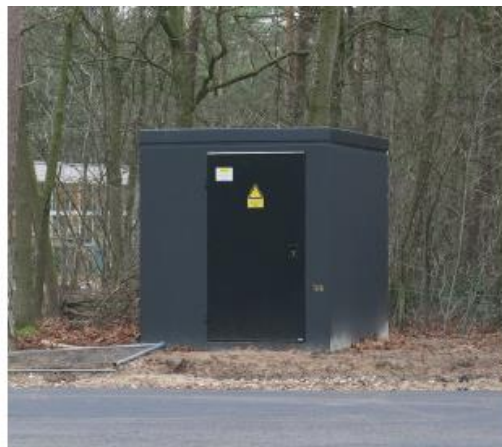
TRAFOHUIS AKA Gräper transformator station, 370x240x347, kleur RAL 9011 grafietzwart
